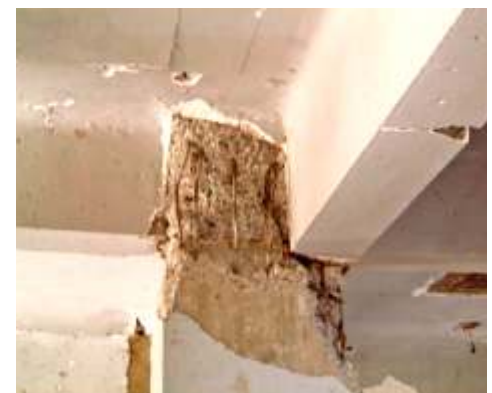
Fig III-8 Torsion locale causée par désaxement
