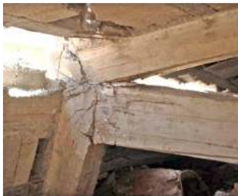
Fig 1-4 Destruction du nœud, le poteau est sorti du plancher, Coopérative Boumerdès
