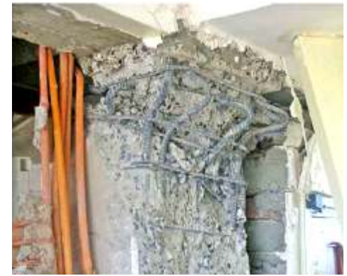
Fig III-7 Rupture du poteau se trouvant en centre de torsion
