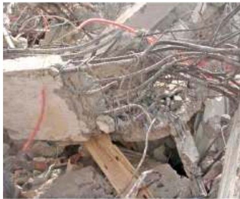
Fig II-1 Ferrailage excessif de la poutre
