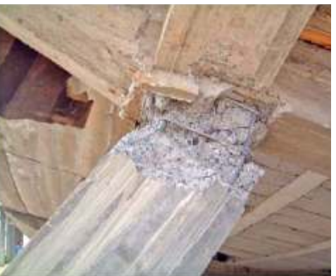
Fig III-2 Effondrement d'un bâtiment causé par éclatement des dés
