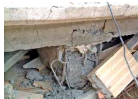
Fig III-5 Arrachement du poteau de la poutre à cause des malfaçons
