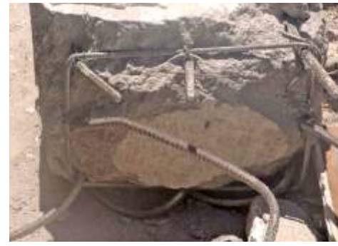
Fig III-4 Glissement du poteau par rapport à la poutre. (Présence d'une surface lisse)
