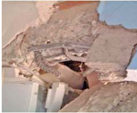
Fig II-2 Le poteau s'est détaché de la poutre
