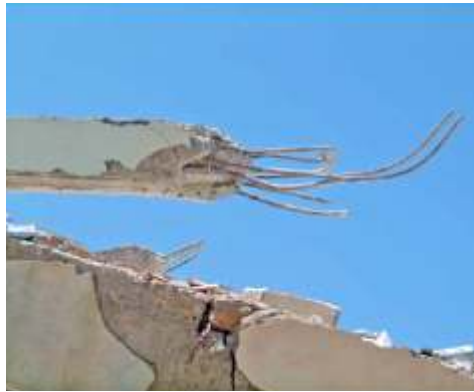
Fig II-3 Détachement du poteau dû à l'éclatement du nœud
