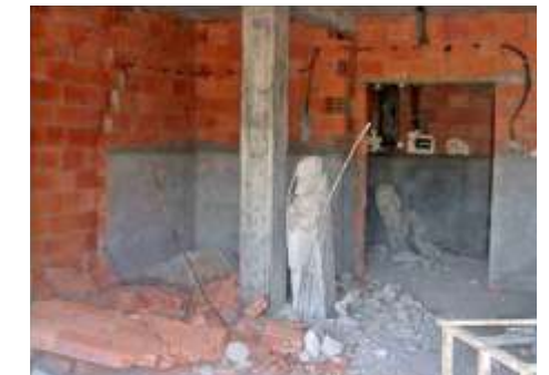
Fig I-2, destruction des nœuds de rez-de-chaussée, Zemmouri
