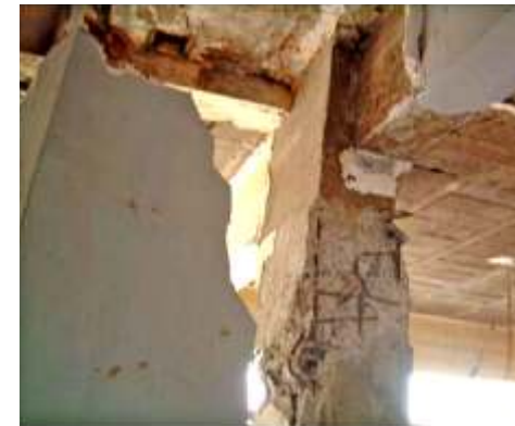
Fig III-9 Destruction du nœud à 45° causée par la torsion locale
